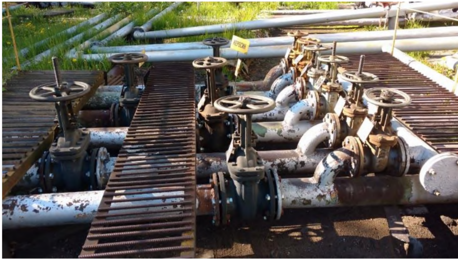
Рисунок 1.13 – Участок нефтепродуктопроводов с запорной арматурой
